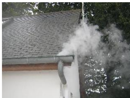
Descente de toit mal raccordée
